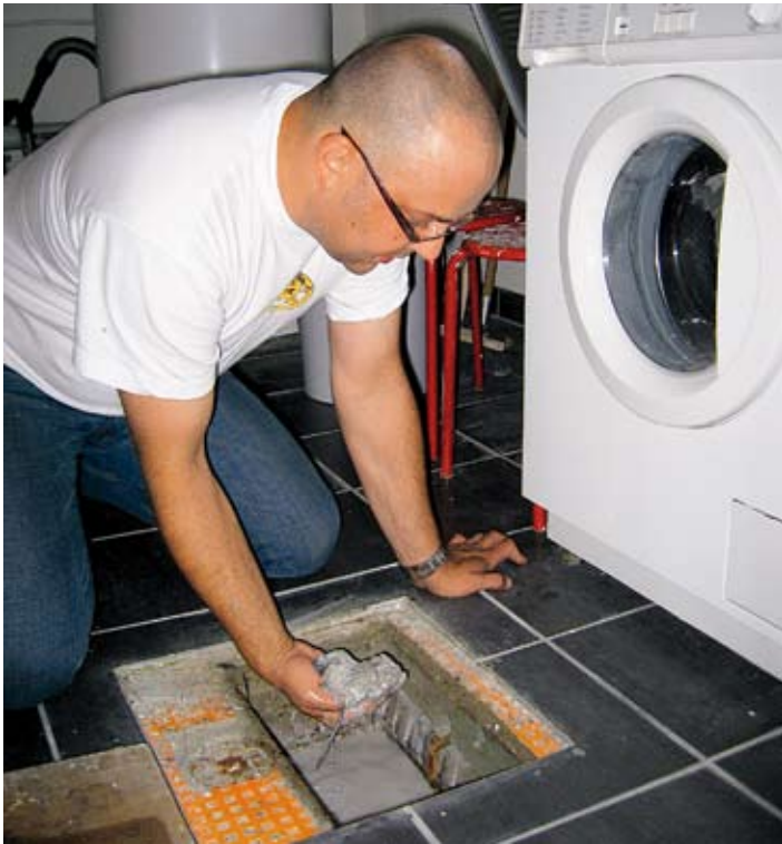
Zum Glück führt RohrMax hier eine Gratiskontrolle durch – das sieht nicht gut aus!
