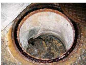
Aus dem Alltag eines RohrMax-Kundenbetreuers: Schlamm-sammler droht mit Überschwemmung.
